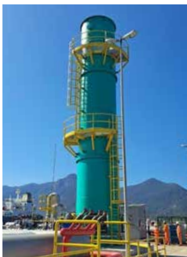
FIGURA 6: Unidade de Combustão de Vapores (UCV) em implantação no Tebar.
