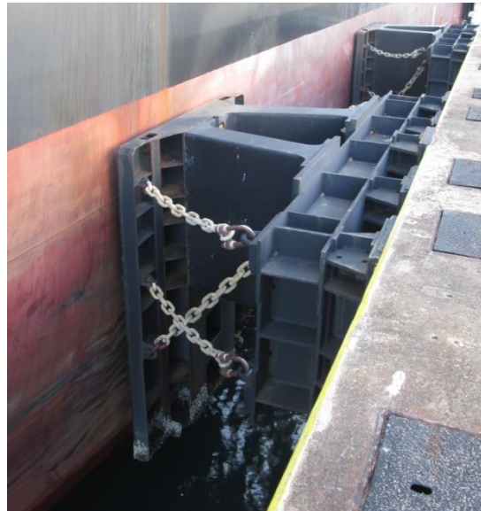
Figura 15 Defensas tipo Pi instaladas no PP4
