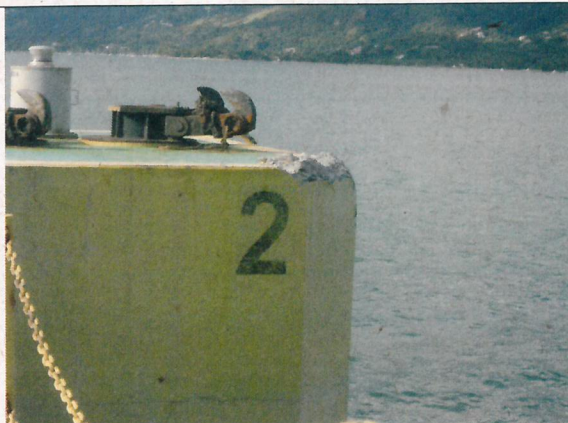
Detalhe do Dolphin 2 avariado durante desatracação de emergência
