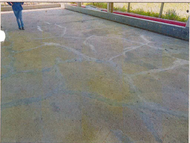
Pátio Classe 1, com manutenção contra rachaduras
