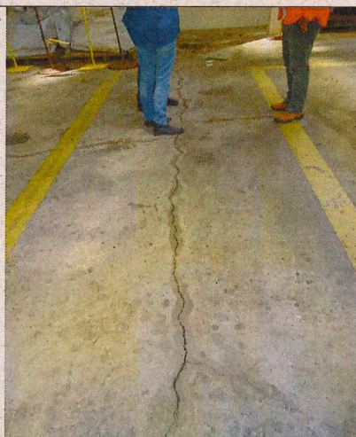
Piso do pátio S4 com rachaduras
