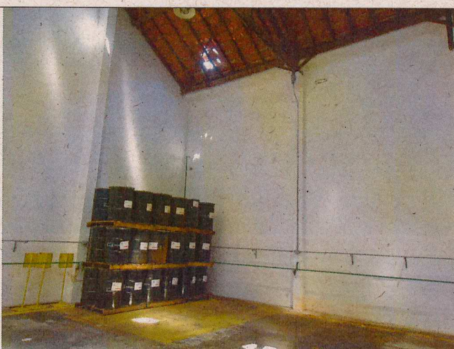
Telhas levantadas, podendo chover sobre resíduos
